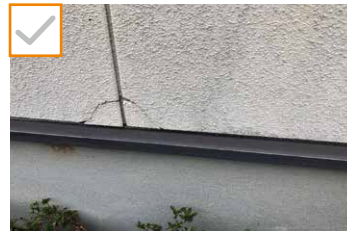
クラック(ひび割れ)・欠け
