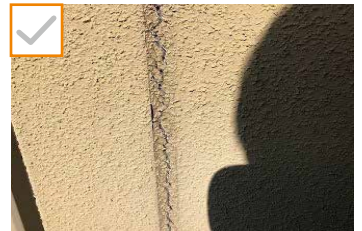
コーキング(充填剤)の劣化
