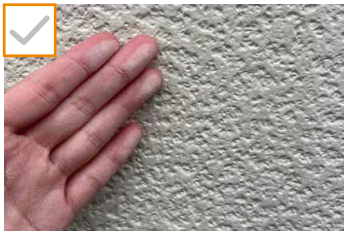
外壁材を触ると手に粉が付く
